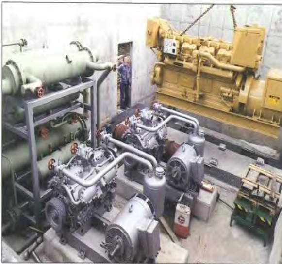
Motor-generatorsæt og andet udstyr på plads i maskinhuset.
